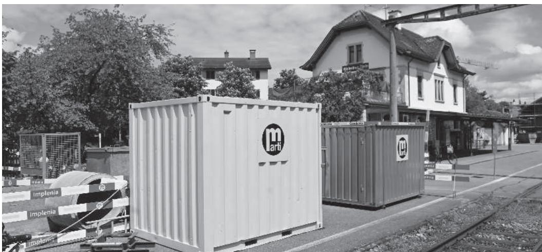
Auch beim Bahnhof Töss haben die Bauarbeiten im Rahmen des Mehrspurprojektes begonnen (Bild: me)
